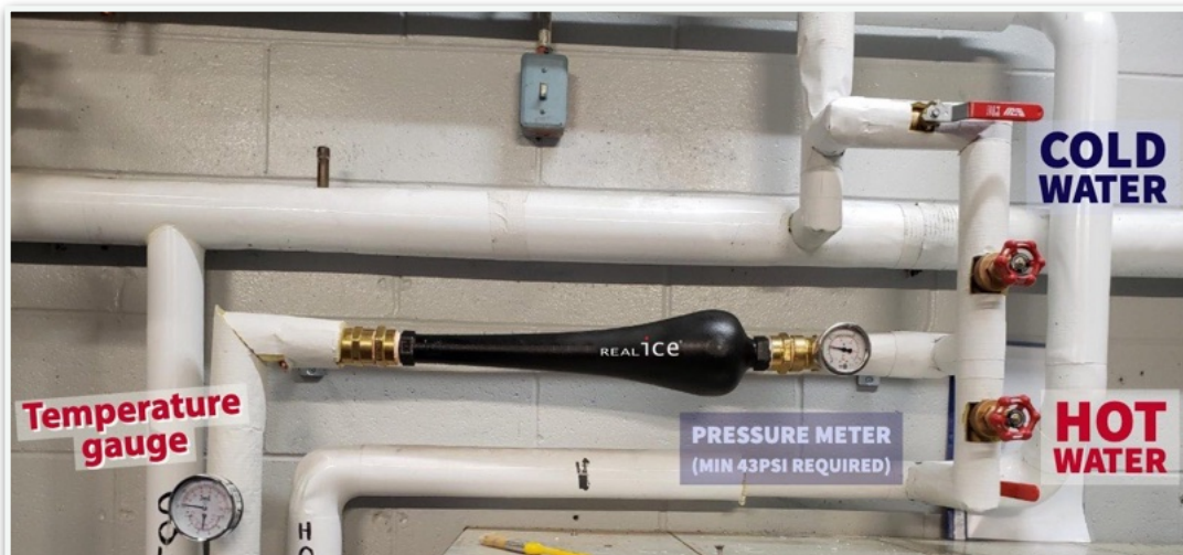
R10x avec adaptateurs 1 1/4" en laiton (mâle) installés horizontalement. Alimentation en eau froide et chaude contrôlée par des vannes à bille.
