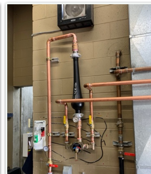
R12x a installé l'eau verticalement circulant vers le haut avec des adaptateurs Victaulic (mâle) de 2" et une vanne mélangeuse Leonard TM-150-AT.
